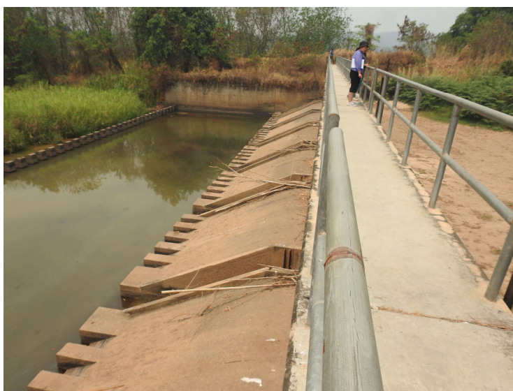
ภาพที่ 6.3 ฝายคอนกรีตกรมชลประทานสร้างสนองพระราชดำริ ที่มา : ถ่ายภาพโดย ชุสิทธิ์ ชูชาติ
